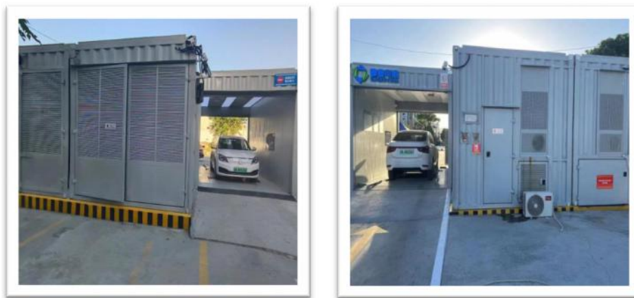
图 33 杭州转塘里街换电站实景图
