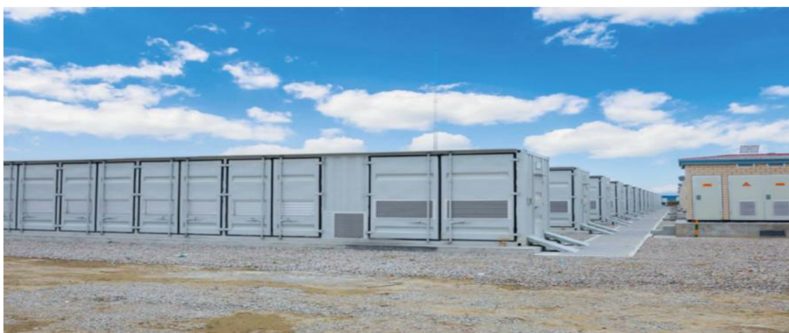
图 41 广纳蒙西矿山储能电站实景图
